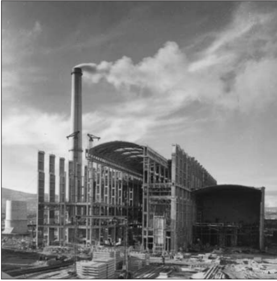
A főépület: bunkertér, kazánház, tápház, gépház
