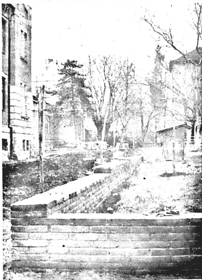
Régen hiányoltuk már az óvoda körüli kerítést. Most — mint felvételünkön is látható — javában készül, hamarosan befejezik építését a szakemberek.
