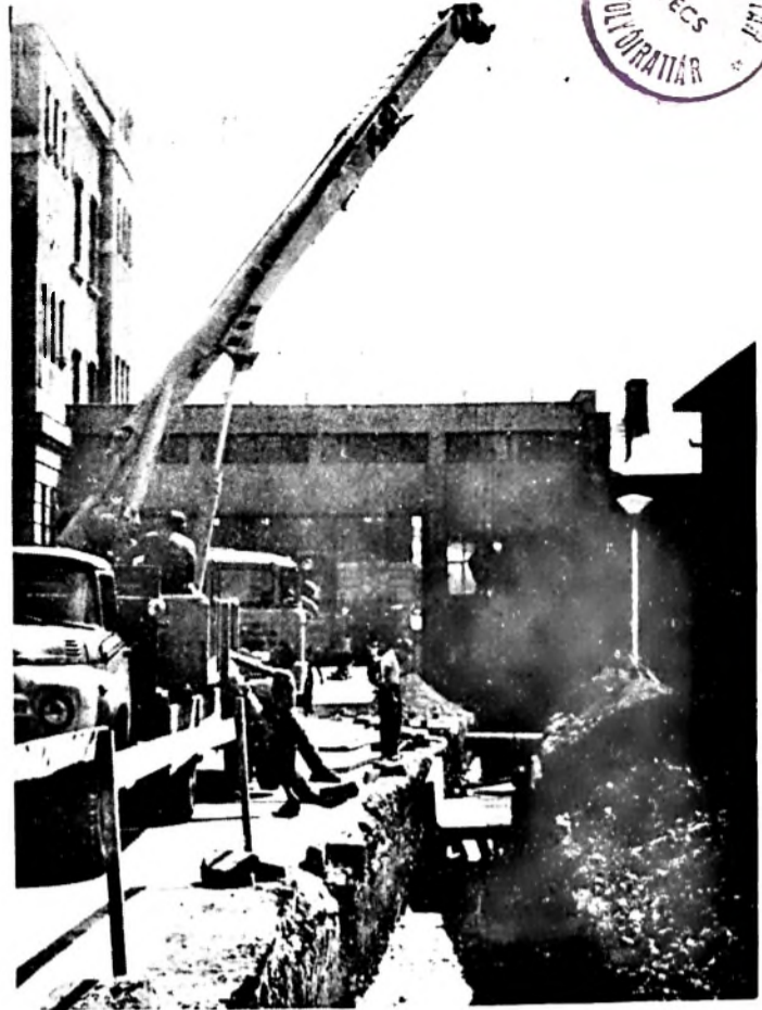
Uj fűtővezeték. A közmelegítési munkák során sor kerül a fűtővezeték cseréjére is. Képünkön a hőközpont és a villamos műhely épületek közötti hőcsatorna betonelemeit helyezik a földre.
