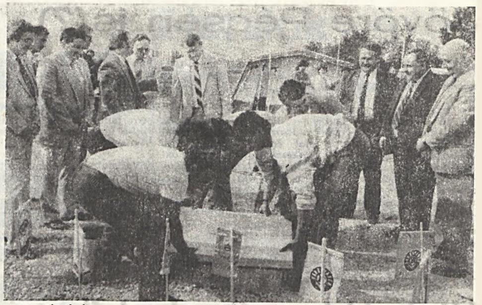
A harkányi út és a Sarohin tábornok útja találkozásánál autós bevásárlóközpont építését kezdték meg. Képünk az alapkövetételek készült, melyen a Baranya megye és Pécs város vezetői és Beck Tamás kereskedelmi miniszter is részt vett. A két és félezer négyzetméter kereskedelmi alapterületű létesítmény ígéret szerint 1990. év végére készül el.
