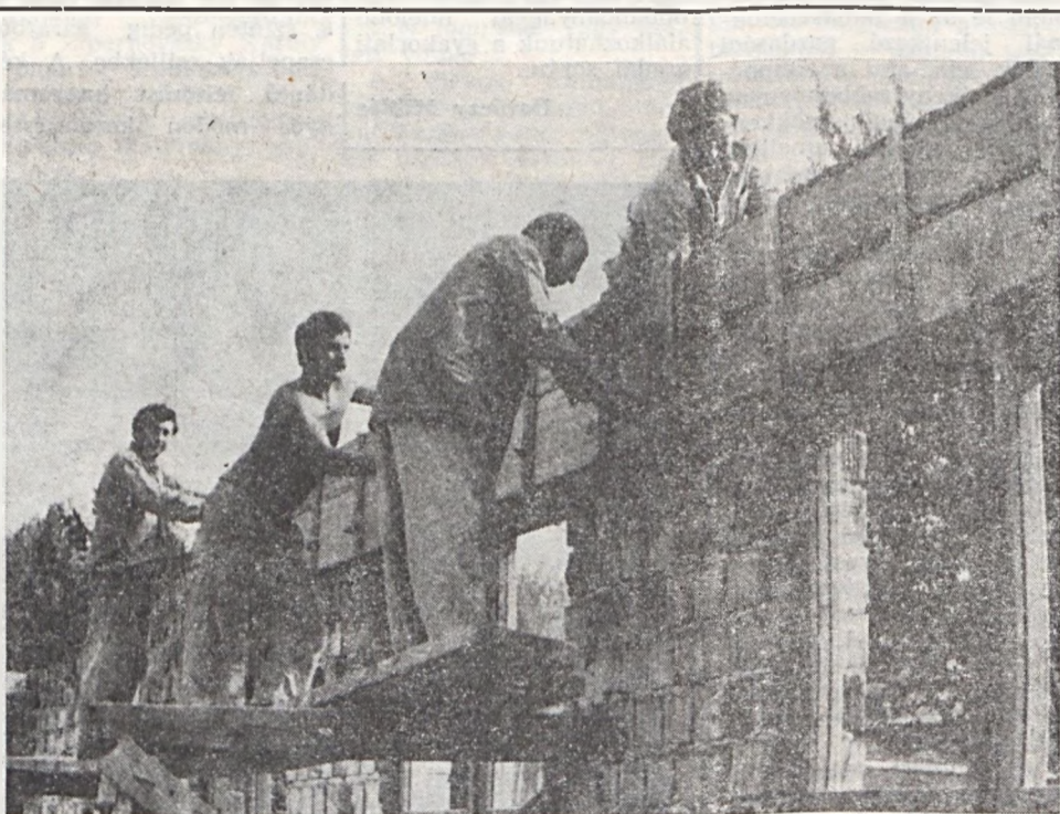
Jó ütemben halad az ÉDÜ kultúrházának felújítása. A blokkfalazás elkészülte után nyílászáró szerkezetek beépítése után betonkoszorú szaluzását végzik az üzemépület karbantartó üzemszolgálatosai.
