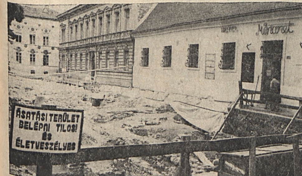
Nagyszabású ásások folynak a Hotel Tourist előtti területen, ahol megtalálják Memi pasa fürdőjét. Az ásások egyelőre leletmentő jelleggel folynak.
