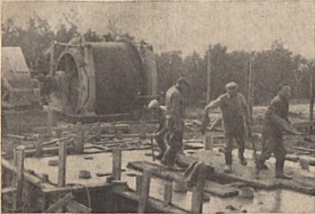
A végleges aknamélyítési technológiához szükséges szállító gépek szerelését és a villacsoport alapozási munkáit végzik az OBV és a BAÉV dolgozói.
