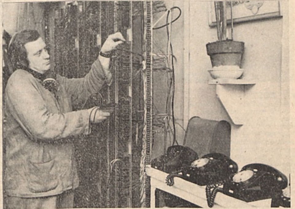
ARCOK AZ ÜZEMBŐL. Színhely a hatos számú telefonközpont, ahol Schmidt György, a Szolgáltató üzem telefonműszerésze vonalvizsgálatot végez a rendezőn (Keller Gábor felvétele)
