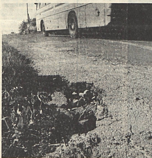
Ugyan, az autópálya-díj drasztikus méretű bevezetését már „felülőli” is megkérdőjelezték, sőt visszavonták, mindenesetre valamilyen pénzfórtósítási terv az ország elhasználatott úthálózatának felújítására. Felvételünk a vasúti üzemanyag-tá-állomástól alig pár méterre készült, de megfelel sem kellett volna hasonló téma után sokat keresgélni. Fotó: Tóth László
