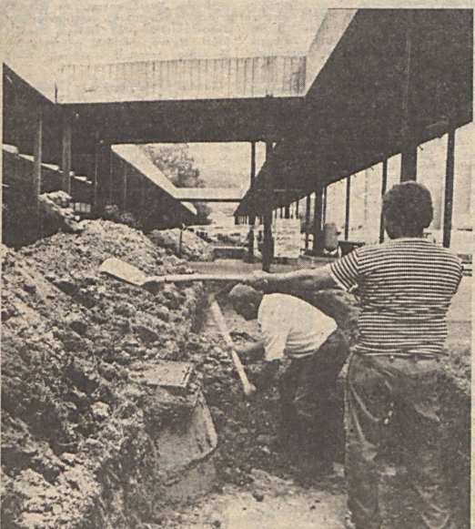
A komlói Kossuth Lajos utca nyomvonalán haladó gerincvezeték újították fel a távfűtési szűznetben a PÉTÁV komlói művez-tőségének szakemberei. Megvizsgálják, s szükség esetén ki is cserélik az árkádsor alatt húzódó öreg csöveket.
