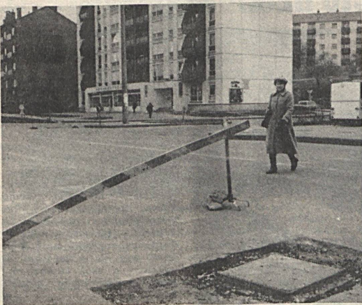
Sokan bosszankodással, vagy legalábbis értetlenséggel fogadták Komlón, a Kassuth Lajos utca aszfaltburkolatának ismételt felbontását. A fátca forgalmát 10-12 helyen fűtőszelvények korlátozza a víznyelő rások és akna-fedlapok megsüllyedése miatt a sztráthozási munkák végzése. E javításokat decemberben már egyszer elvégezték a Pécsi Közüti Építő Vállalat - akkor is garancián, hisz 86-ban ők csinálták a KPM megrendelésére az aszfaltburkolat lerakását - ám a hideg idő és a járművek korai terhelése, nem tette lehetővé a beton kellő kötését. Januárban és februárban az időjárás kegyes volt, ám a kiválítatlan(!) korlát orról árulkodik, hogy a befejezésre várni kell... Fotó: Tóth László
