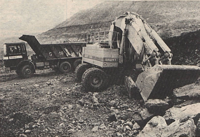
A Külfajti Üzem munkahelyein korszerű berendezések segítik a termelést. Képünkön a nagyteljesítményű Broyt kotrógép gépkocsira rakja a meddőközetet. A felvételeket Tóth László készítette
