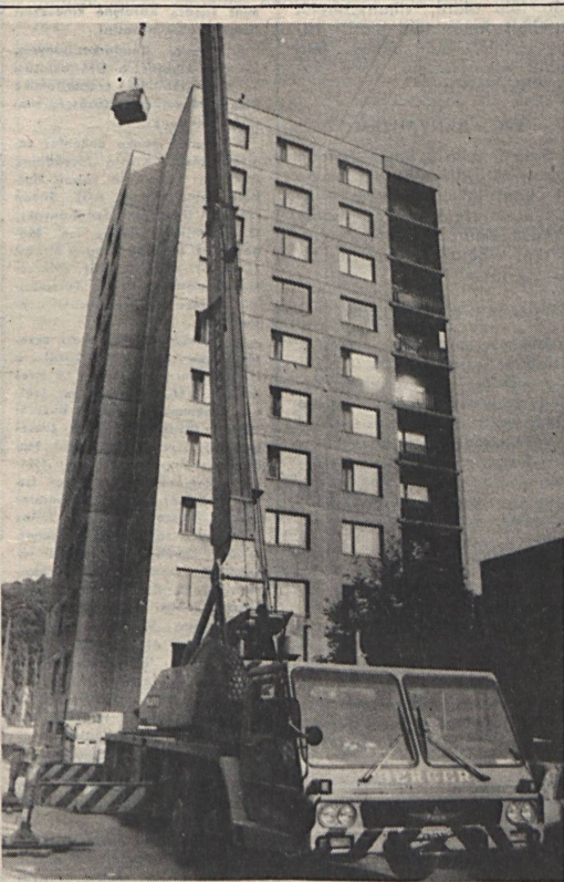
Komlón, a Városgazdálkodási Vállalat a Zengő Áruház mellett 10 emeletes házak tetőszigetelését véggezteti az ELISZ szakembereivel. Képünkön a Baranya Megyei Építőipari Vállalat nagy teljesítményű autódarujával emelik fel a szigetelő anyagot. Fotó: Kórdi Gábor
