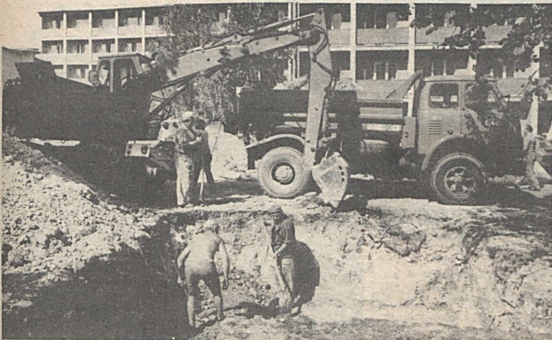
A rossz szigetelések megszüntetése, az üzembiztos hőszolgáltatás érdekében folyamatosan felújítják Komló távhővezeték-rendszerét. A 70-es évek elején lefektetett csöveket szükséges korrozóvédelem, festés és javítás után ismét visszabetetjük. Kóródi Gábor felvétele a kőkönnyosi munkásszálló előtti parkban készült.
