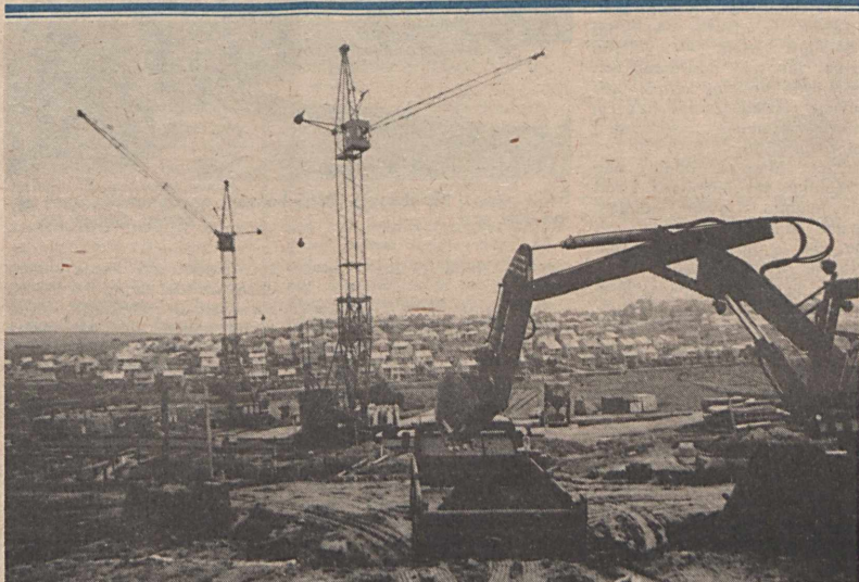
A Tolna megyei Állami Építőipari Vállalat szakemberei az elmúlt héten megkezdtek a sikondai új városrész panel épületeinek szerelését. Lapunk megjelenésének időpontjában már készen áll az első ötszintes ház fogadószintje és holnap a további öt épület alapozási, betonozási munkálatai is.
