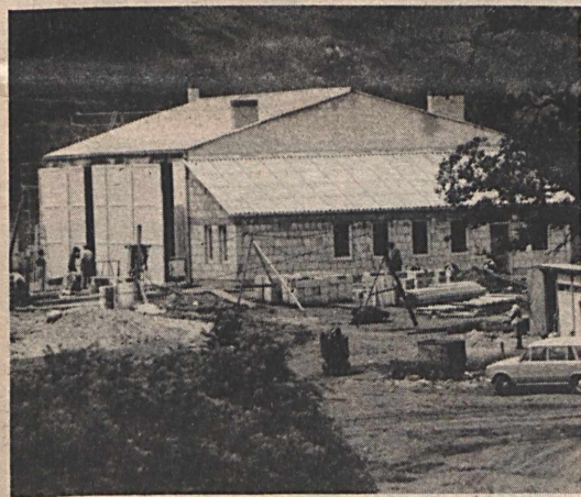
Elkészült Vasason a külfejtés területén egy 334 négyzetméter alapterületű munkagépszín. Az épületben helyet kapnak a speciális létesítmények, így például a fürdő, melegedők. Az épület bontott anyagokból készítette a Mecseki Szénbányák Építési Üzeme, és így jelentősen csökkent a létesítmény beruházási költsége. Kóródi Gábor felv.
