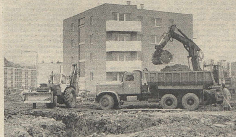
Újabb két lakóépület alapoz Szilvasban a Mecseki Szénbányák Karbantartó Üzeme. Még az idén tető alá szeretnék hozni az épületet és még két épület alapozási munkát szeretnék befejezni.
