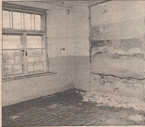
A felújításra váró iskolaépület egyik tanterme, közvetlenül a kiköltöztetés után. Fotó: Kóródi
