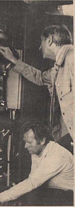
Előrelépés történt a metángáz hasznosításban. Kossuth III-as aknáknál két hete üzemel a képen látható gázkazán, amely kiválóan alkalmas a bányában felszabaduló gáz elégetésére, s ezzel létesítmény fűtésére, valamint a melegvíz előállítására.
