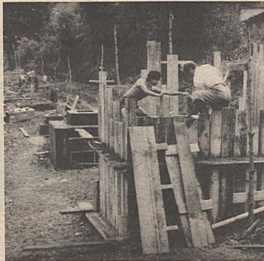
Komlón, a Mecsekaljai út mentén a TÁÉV szakemberei megkezdték az új sikondai városrészt hótávvezeték tartószerelvények építését. Képfőnök a vállalat dolgozó az alapok szulazását végzik. Fotó: Kóródi Gábor
