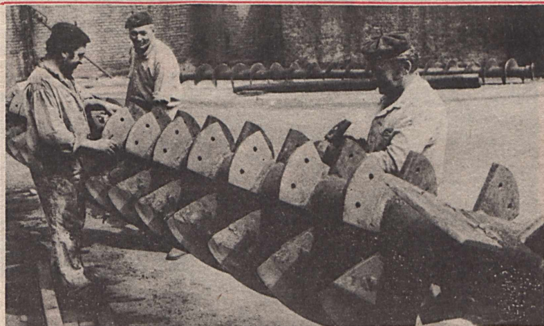
Az évente esedékes nagyjavításokat végzik a nagymányoki brikettüzemben. A gépek felújítása mintegy kétfélmillió forintba fog kerülni. A jelentős munkálatok miatt a termelés augusztus 1-től 24-ig szünetel. A felújításban háromszáz dolgozó vesz részt. Képünkön a kettős keverőgép csigatengelyét javítják. Fotó: Kúrdi
