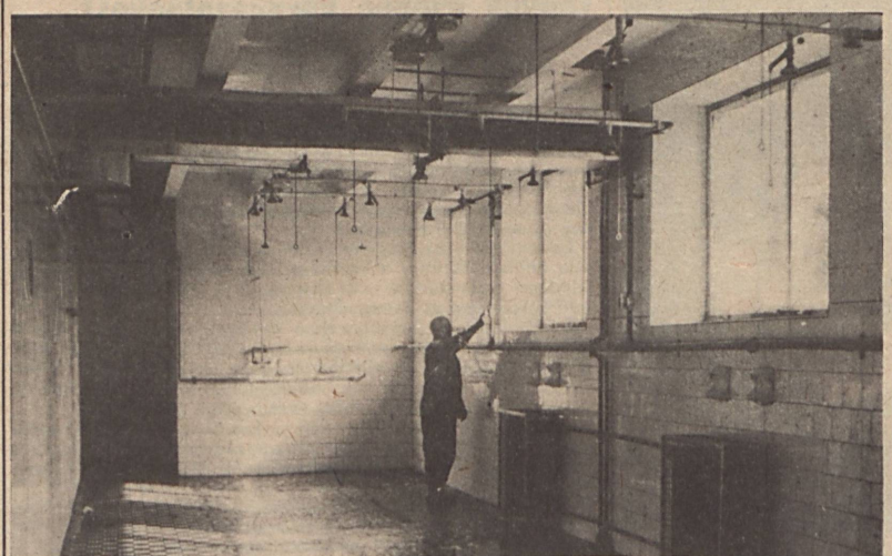
Januárban kezdtek hozzá Mázasszváron Észak-bányászüzem fürdőinek átépítéséhez. Elsőként a férfifürdő korszerűsítésével végeztek az építők, a közelmúltban pedig átadták a felújított női fürdőt s az aknásfürdőt is. Kóródi Gábor felvétele
