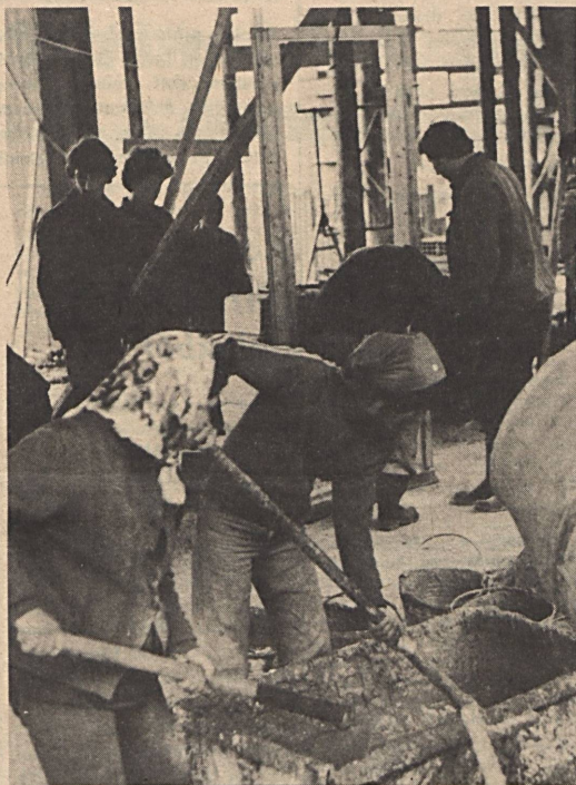
A Carbon Könnyűipari Vállalat Ybl Miklós szocialista brigádja KISZ-védnökséggel építi az új cipőüzemet. Képfőnök: a szociális épületszámny alapoásán dolgoznak. Fotó: Kóródi Gábor
