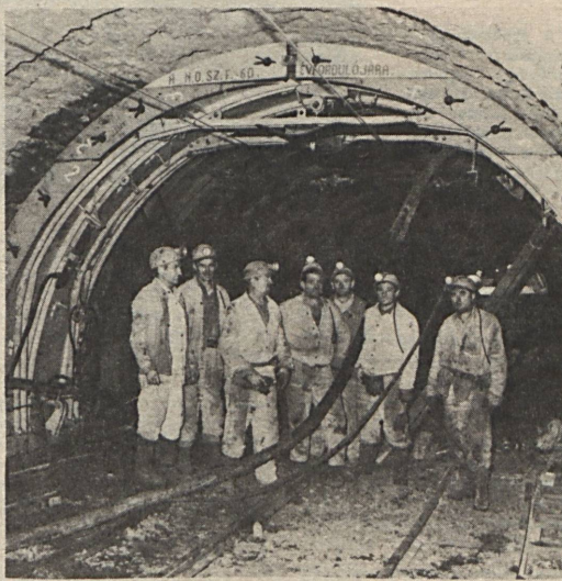
A Biró János vezette szocialista brigád végzi Kossuth-bányaüzemben az alagútszaluzat felújítást. Fotó: Schmidt
