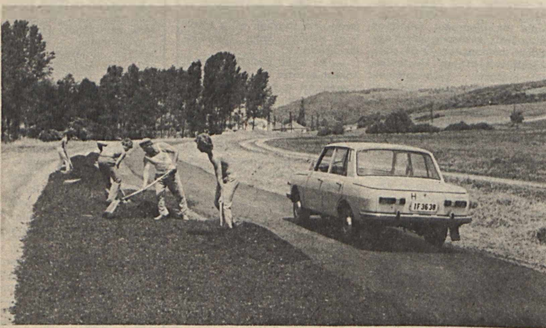
A KPM Közúti Igazgatóság útkarbantartó részlege mintegy 10 kilométeres szakaszon bővíté a Komló-Bonyhad közúti utat. Fotó: Körödi
