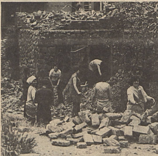
A Carbon Könyvgyártó Vállalat szocialista brigádjai és munkakollektívái társadalmi munkában vettek részt az elmúlt héten Komlón a Kossuth Lajos utcában szanálásra ítélt volt háztartási bolt épületét. A bontásból származó anyagot a vállalat saját céljaira használhatja fel.
