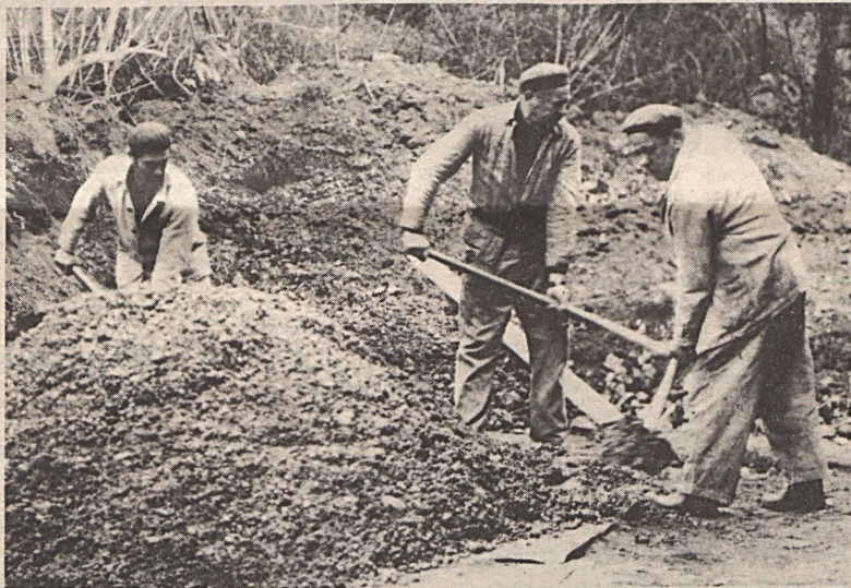
A Vasason épülő villamosüzemi raktár alapozása közben betont kevernek az Építési Üzem dolgozói. Hol vannak a kisgépek?!
