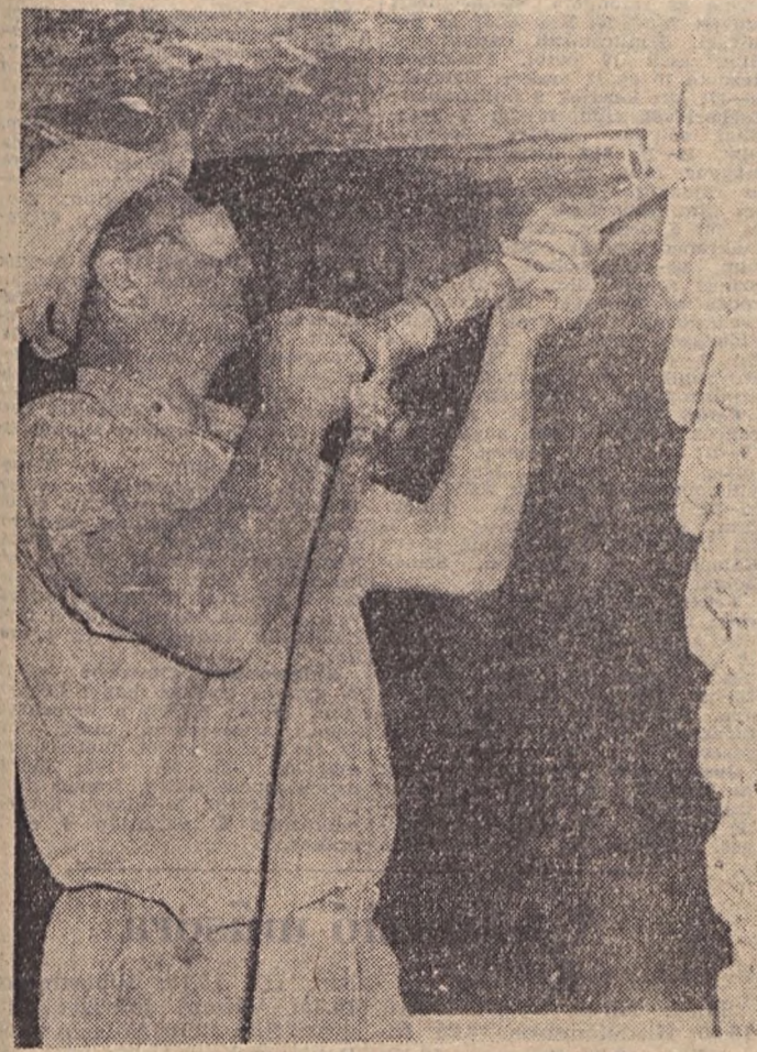
A legnagyobb munka jelenleg a tartóoszlopok megerősítése. Ehhez először ki kell faragni a betont, hogy majd jobban kössön. Ezt a munkát végzi Gungl János kőfaragó.
