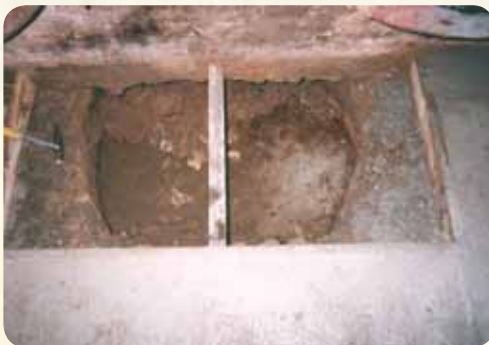
8. sz. melléklet: a Püspöki-pince padozata alatti vízvezeték kezelőaknája
