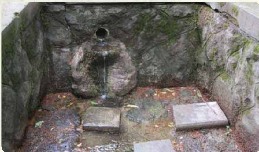
7. sz. ábra: A támfalba helyezett kifolyócsőnél már megkezdődik a mészanyag kiválása
