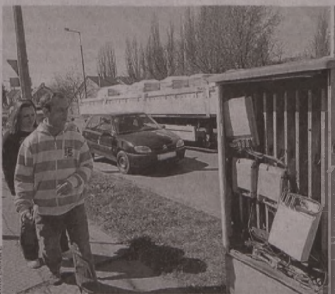
Kapcsolószekrény-ajtót, vezetékeket és aknafedőlapot is elvitték. Nem kispályáztak a közelmúltban a fértoltojok Pécssett, a Megyeri úton, a vasúti átjáró déli oldalán. Az erre járók megdöbbenve látják a nagyméretű távközlési szekrény ellopott ajtaját, a teljesen kiszakított és elvitt vezetékek hűt helyét. Néhány méterrel arrébb egy gázvezeték tolváraknájának fedelét lopták el, a rongálás mellett balesetveszélyt is okozva
