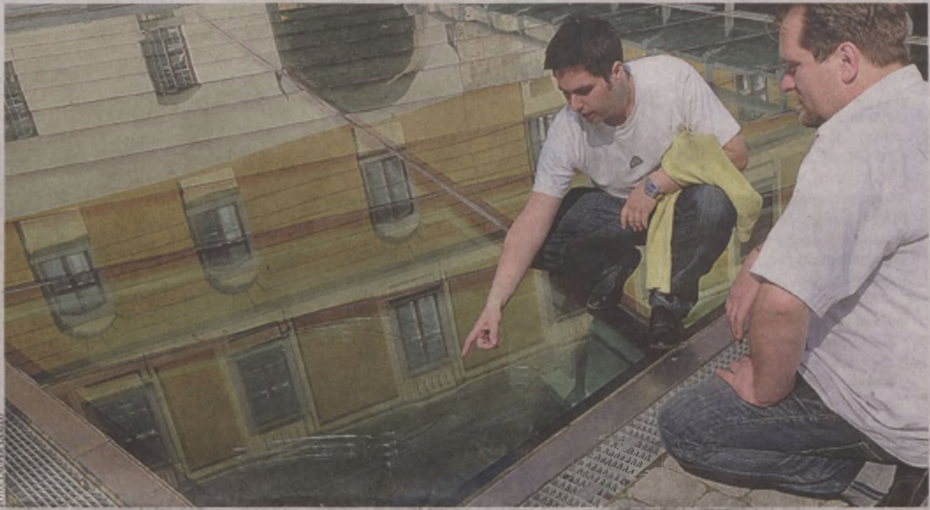
Újabb törés, repedés a pécsi világörökség különleges üvegtetején: ismét vandálok fitogtathatták erejüket a Sétatéren és környékén
